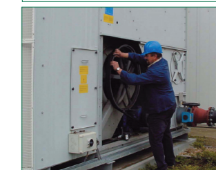
Système d'entraînement de ventilateur au niveau du sol facilement accessible
