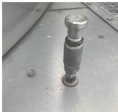
Sfiato su piattaforma ventilatore
