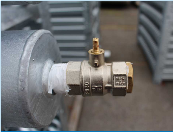
Conexión de batería no roscada con válvula de alivio de presión en equipo de almacenamiento térmico para alimentación de refrigerante directa.
