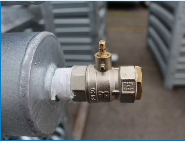
Oberer Rohrbündelanschluss mit Überdruckventil auf Verdunstungsverflüssigern.
